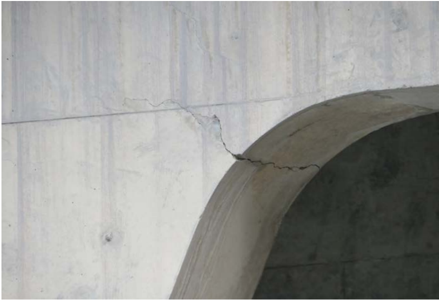
原桥拱肋裂缝
